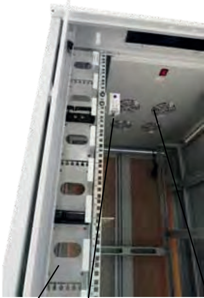
Kabelkanal, Temperatureinheit, Lüfter
