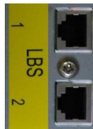
Abb. 3-27 LBS-Anschlüsse 1 und 2 an der Rückseite der USV-Anlage.
